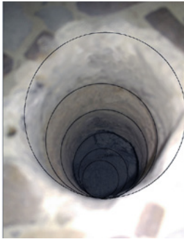
Figura 2 - Sección de la solera y el sustrato (arriba.) y perforación en solera y sustrato (abajo)
