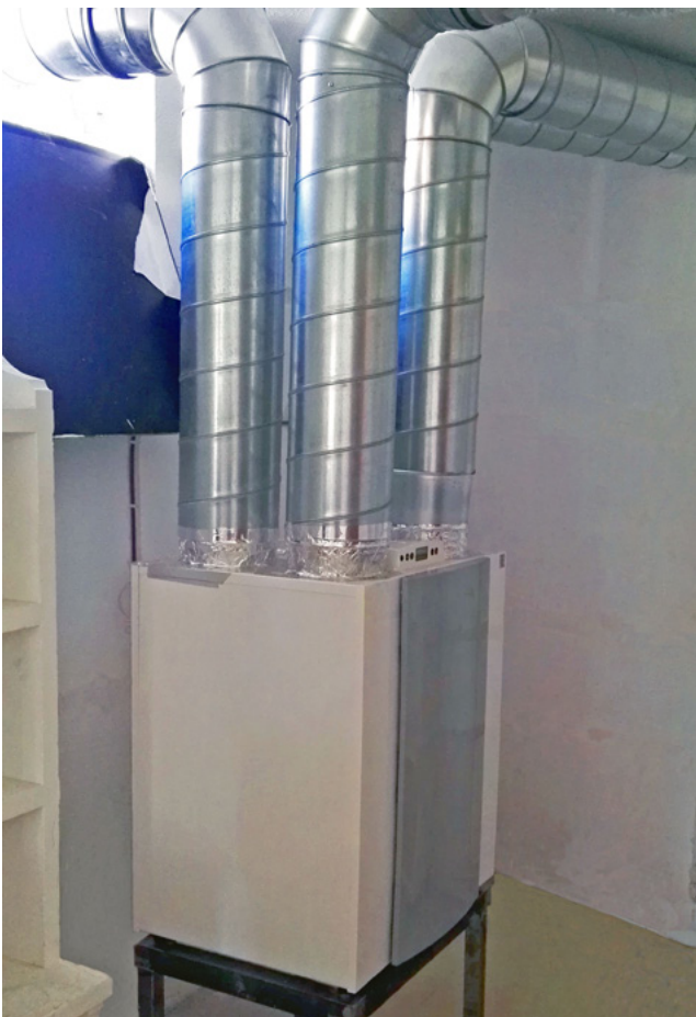
Figura 5 - Equipo de ventilación
